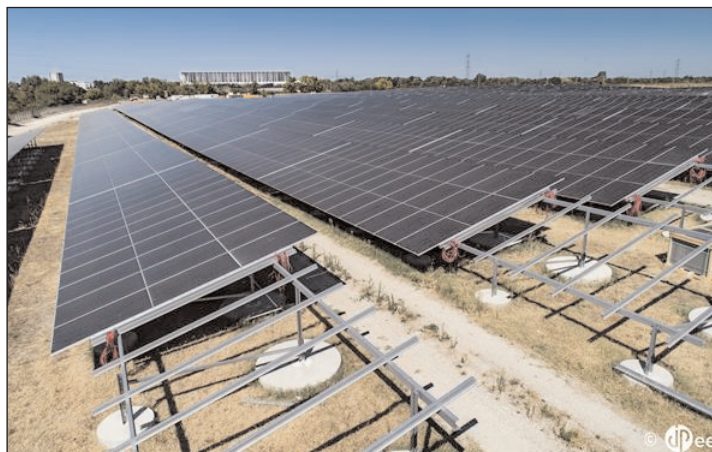
JP Energie Environnement's 59MW DC Labarde solar power plant.
